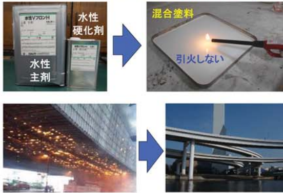
【首都高(2015年)塗装中に火災死亡事故】 【現在は大規模試行工事実施中】
