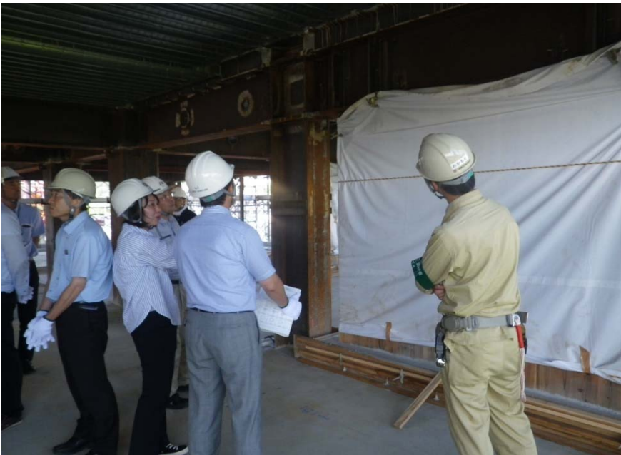
シーートの裏側にCLT耐震壁 が設置されています
