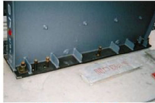
▶耐震壁設置状況(クリックで拡大)
