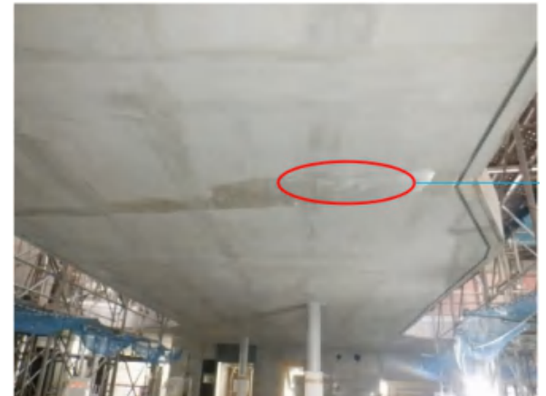
中庭スラブひび割れからの漏水が なくなる 2022年9月14日撮影
