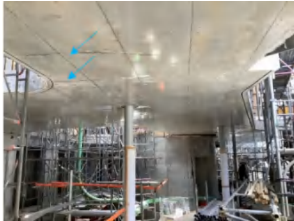
中庭スラブに発生したひび割れ
