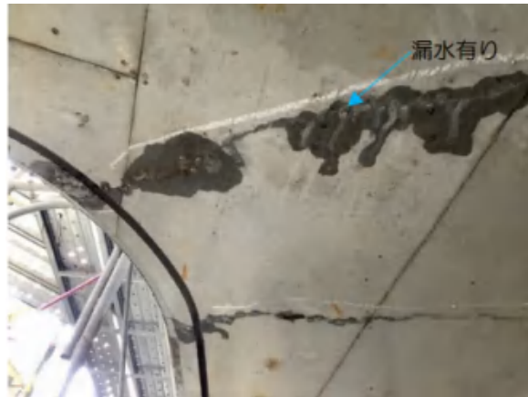
中庭スラブひび割れからの漏水 2022年6月1日撮影
